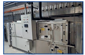
Az uszoda levegőjét kezelő szellőztetőgépek
