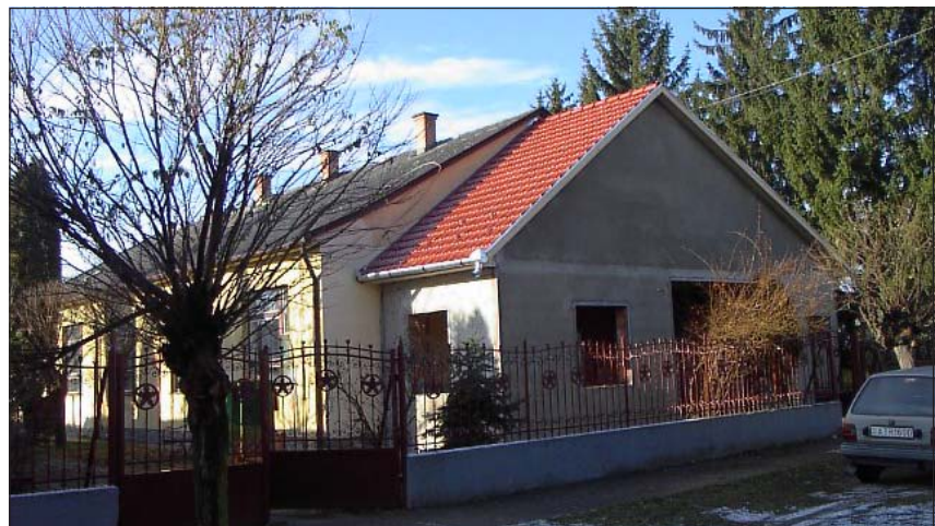
Készül a Bajcsy–Zs. úton a Szociális Gondozási Központ bővítése, akadálymentesítése. Az egyszerű közbeszerzési eljárás lezárását követően a Vörös Pillér 73 Kft. kivitelezésében 7.656.000.- Ft költséggel 29 m 2 területtel bővül a létesítmény. A fejlesztést a Megyei Területfejlesztési Tanács két éves ütemben 4.500.000.- Ft-tal támogatja. A beruházás befejezési határideje: 2006. június hónap.
