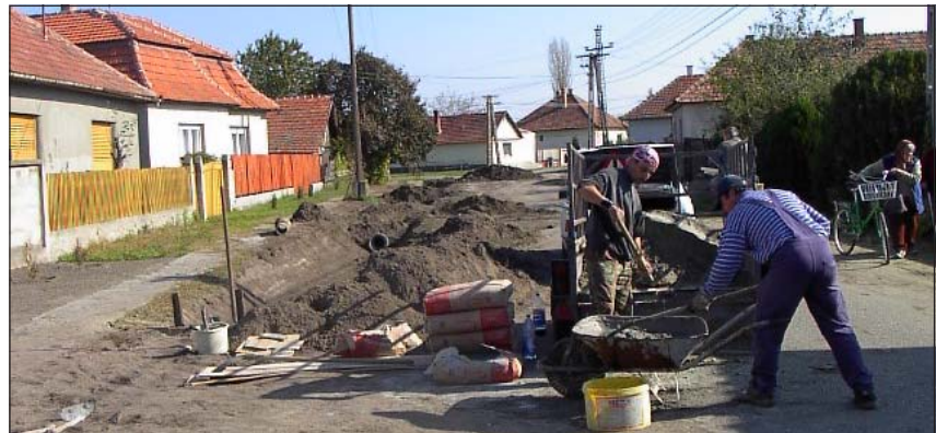
Csapadékvíz elvezetését rendeztük a Boros tó (képünkön) és József A. úti záportónál. A Boros tónál 80 fm árok, kapubejáróknál átereszek elhelyezése, előfejek betonozása, a József A. út végén 80 fm árok tisztítása készült 1.204.000.- Ft költséggel.
