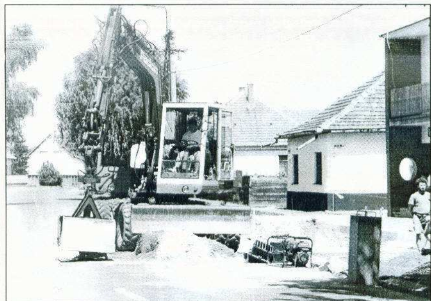
A nyár folyamán elkészült a Szabadság út egy részén a csapadécsatorna és a parkszegély. Felvételünk az iskolával szemközti parkoló építésének munkálatait illusztrálja.
