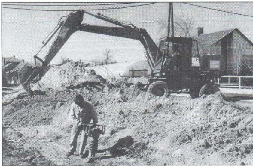
Április első napjaiban megkezdődött a szennyvízcsatorna-hálózat építése az Ifjútság és a Csokonai úton. Az építés kivitelezését a CONTUR BAU Kft. végzi helyi munkások alkalmazásával. Felvételünk a kétéves beruházás első „kapavágásait” örökölte meg.
